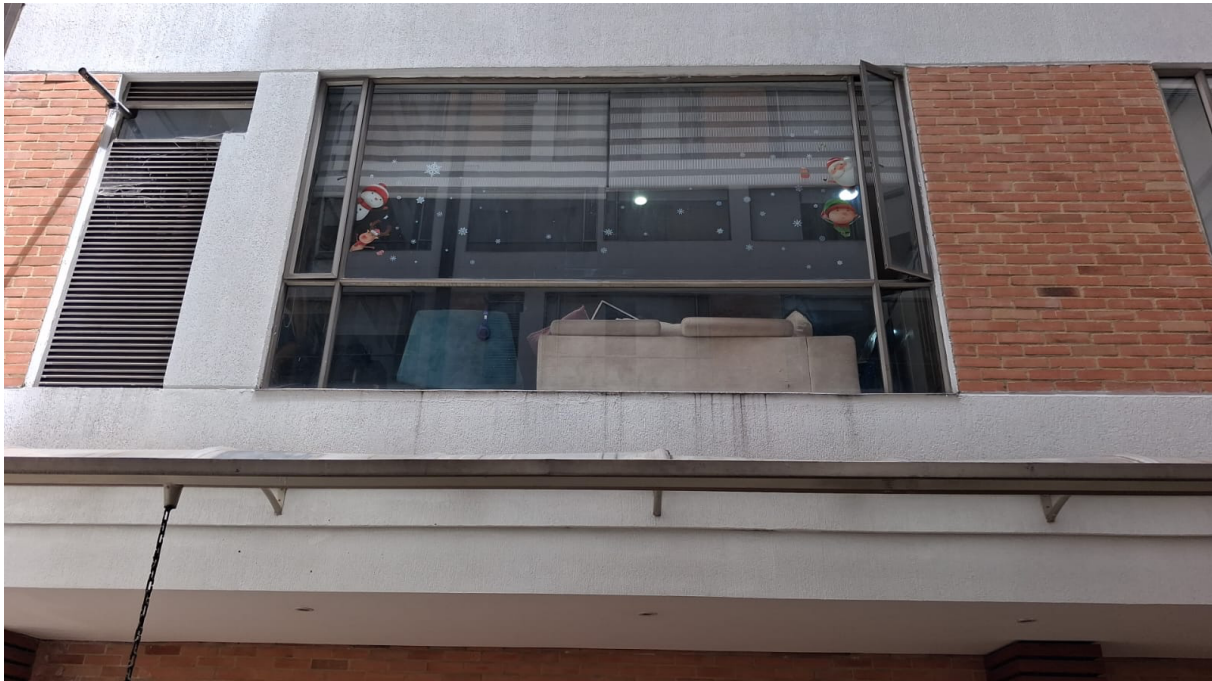
Fachadas en Graniplast manchadas.
