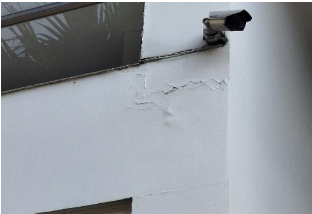
Pintura desprendida por humedades recurrentes.
