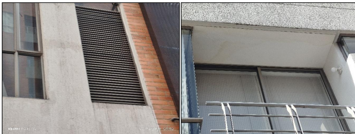
Ilustraciones 7 y 8. Manchas por aplicación de productos para impermeabilizar y manchas de humedad en balcón.
