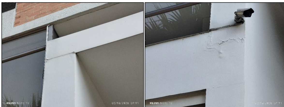
Ilustraciones 9 y 10. Fisuras y desprendimiento de estuco.
