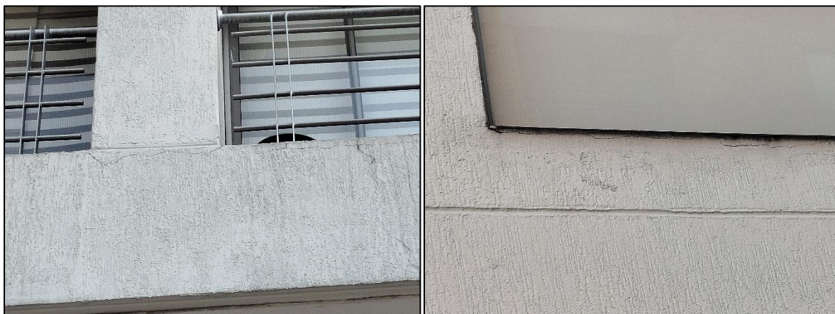
Ilustraciones 5 y 6. Presencia de fisuras.
