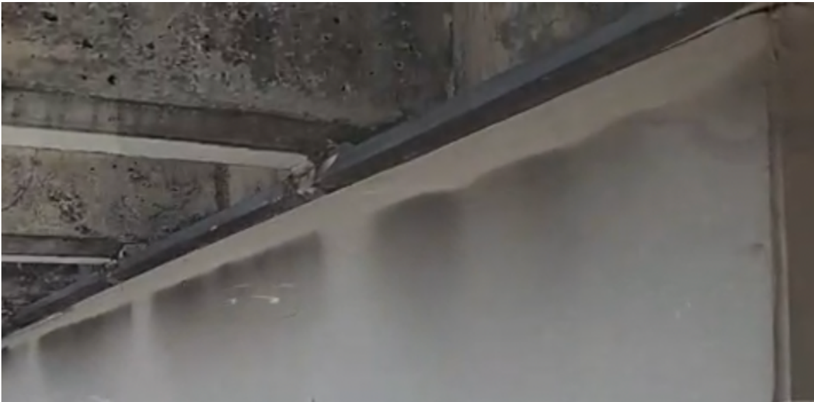
Manchas de polución en paños de pañete.
