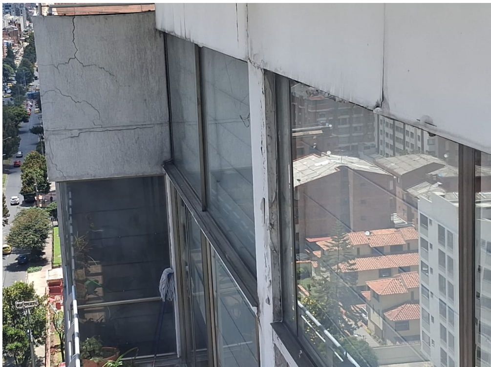
Paños de Graniplast mapeados con fisuras y grietas. Deben demolerse y reconstruirse.
