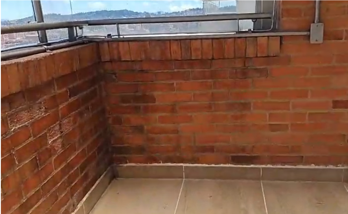
Ladrillo manchado, desprotegido y meteorizado en cubiertas.
