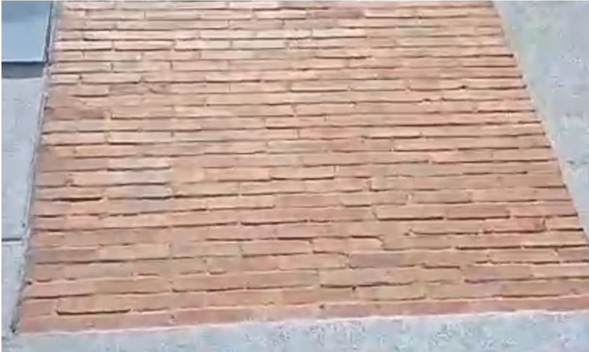
Ladrillo bastante afectado por falta de protección.
