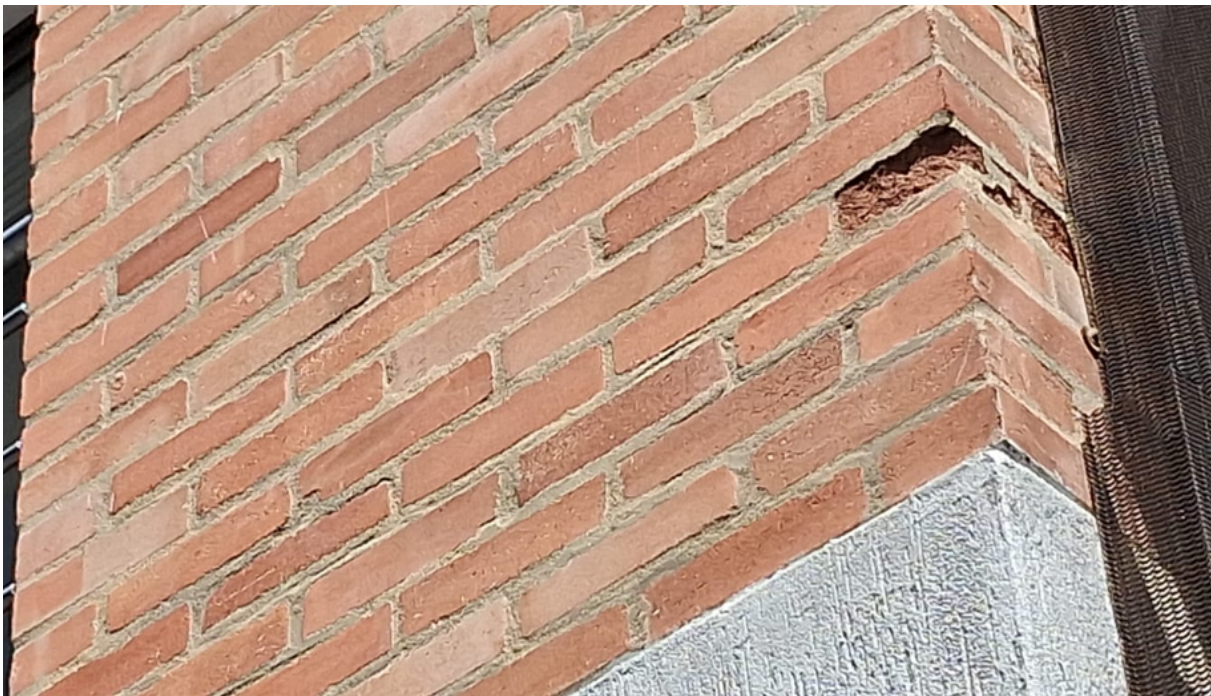
Fotografía del estado de las piezas de ladrillo a cambiar en algunas zonas. Es evidente la meteorización.
